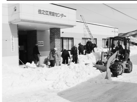
2日目の活動では、スコップなどを使って屋根に積もった雪を下ろした。暖冬の影響で雪が固まっていたため、堆積した雪や下ろした雪の除排雪には重機も使用。窓ガラスを覆うほどに積もった雪をきれいに取り除き、児童や地域住民が安全・安心に施設を活用できるように環境を整備した。同社では、来年度以降も取組を続けていくとしている。
