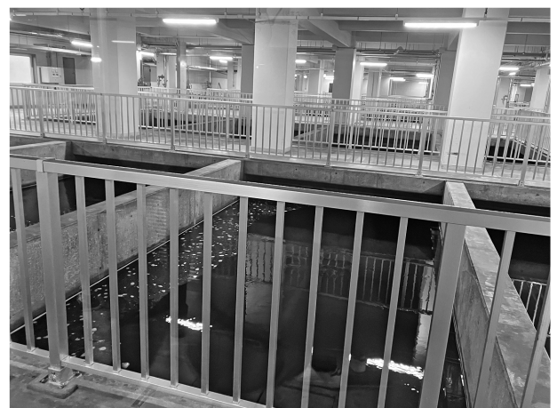
写真-3 藻岩浄水場内部(沈殿池)
