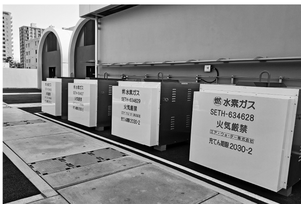
写真-3 水素カードル（19.6MPa、250m 3 /基） 手前：側溝のコンクリート蓋、グレーチング蓋
