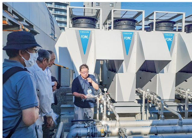
写真-4. 冷却機の前で説明を聞く参加者の面々、排気口の上に網が設置され、積雪防止が施されています
