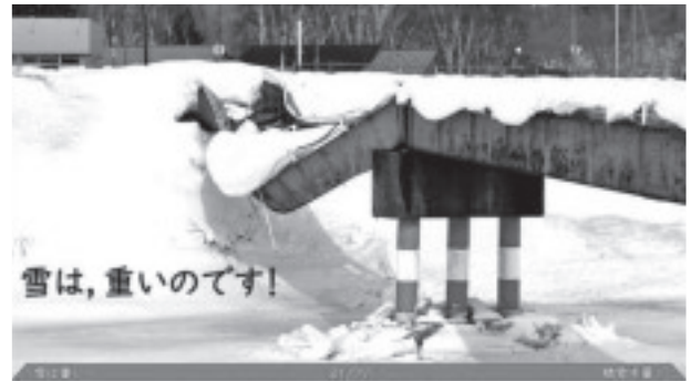
写真-10 雪の重みで倒壊している橋
