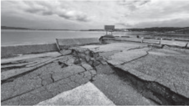
写真-17 被災状況 5
