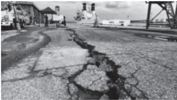
写真-10 七尾港の地震被害の様子
