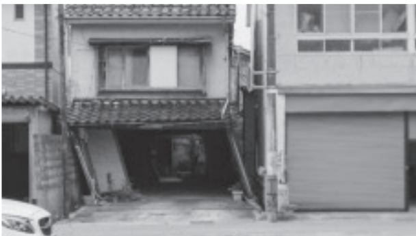
写真-18 被災状況 6 (ほぼ倒壊している家屋)
