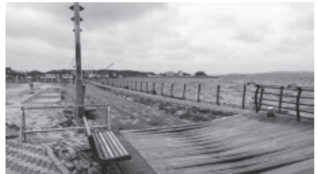
写真-13 被災状況 1
