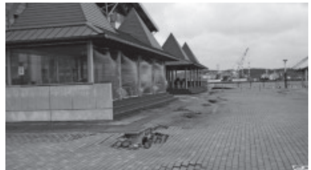
写真-15 被災状況 3
