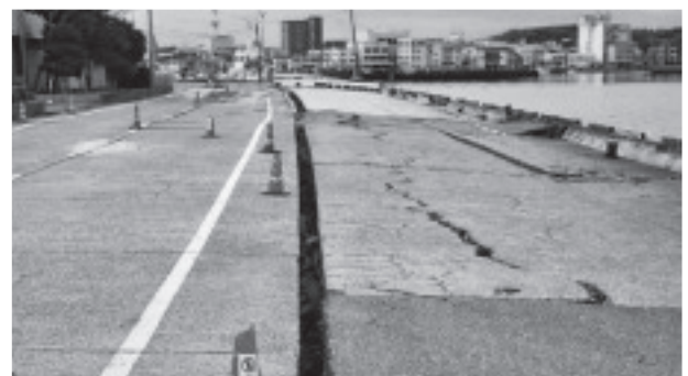
写真-16 被災状況 4
