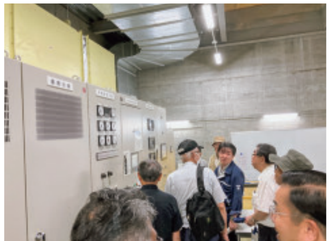
滝の上発電所 操作盤
