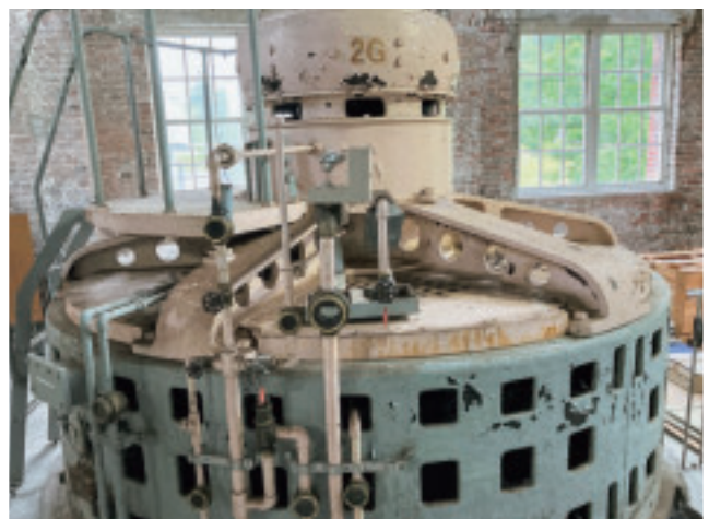
旧滝の上発電所 発電機
