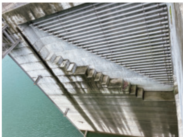
国内最大級の連続サイフォン式取水設備(28 段)
