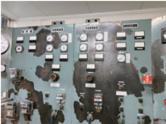
旧滝の上発電所 操作盤
