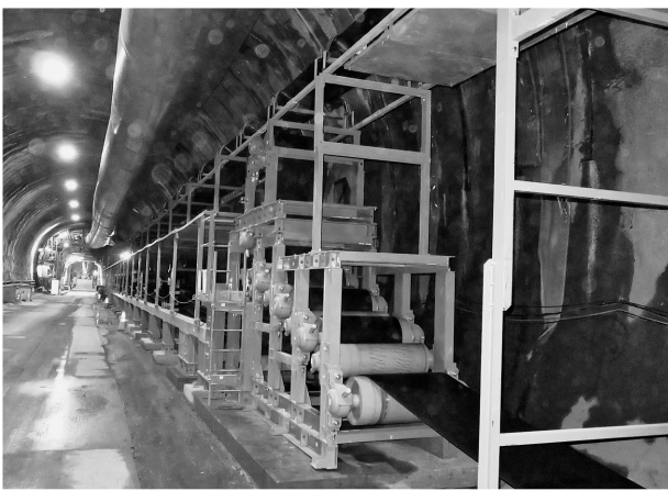
写真-9 札幌トンネル左側側壁のベルトコンベヤ
