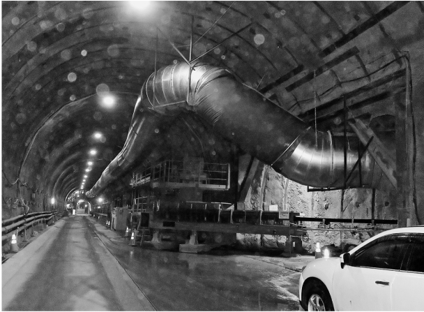
写真-8 札幌トンネル坑口の換気設備
