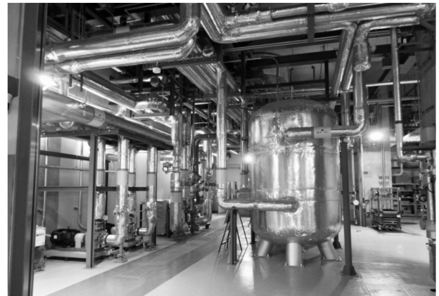
写真-3 温水蓄熱槽
