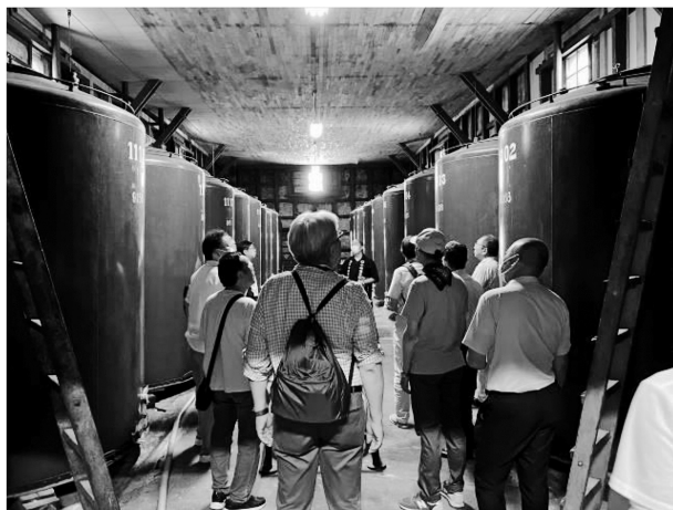
写真-6 酒蔵内部のタンク
