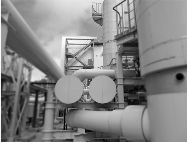
写真-16 鬼首地熱発電所の発電設備配管の状況
