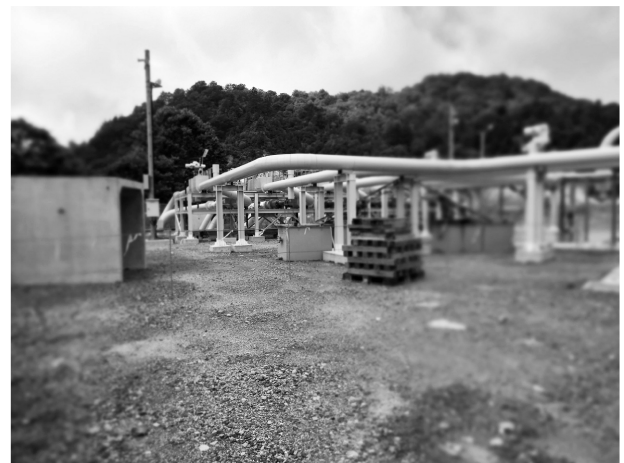
写真-14 鬼首地熱発電所の生産井設備の状況
