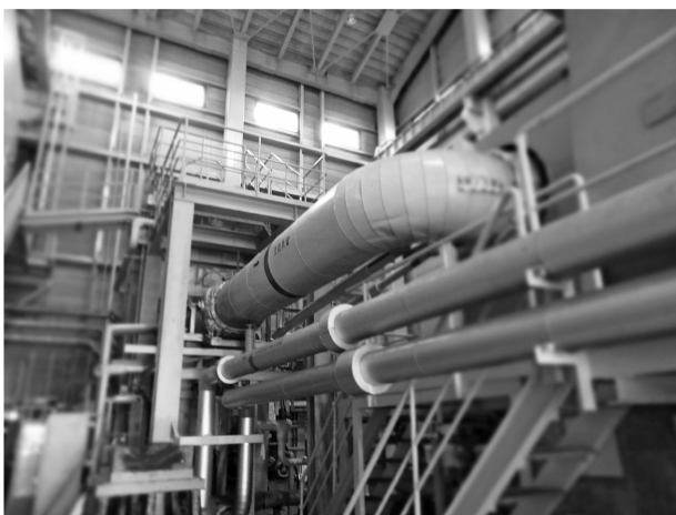
写真-11 上の岱地熱発電所の発電設備の状況
