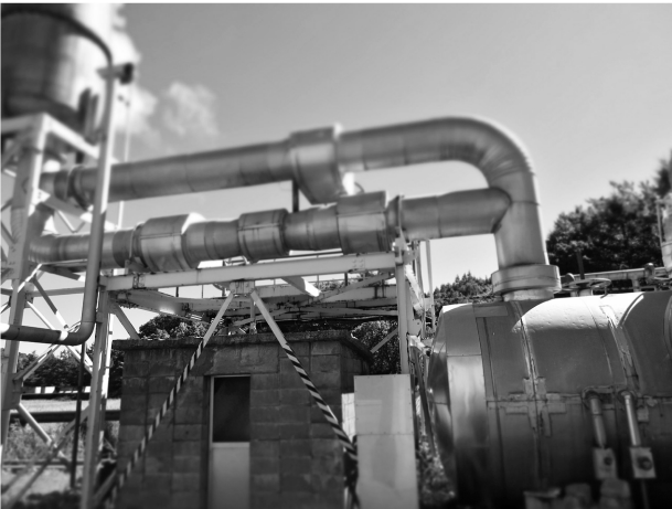
写真-4 大沼地熱発電所の配管の状況
