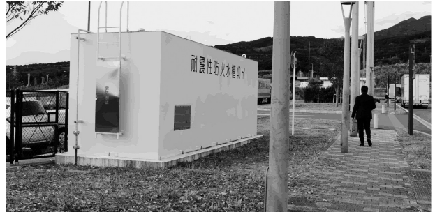
写真-5 耐震性防火水槽(駿河湾沼津 SA)
