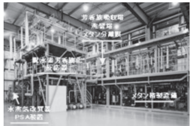
図-7 実証実験施設内の様子
