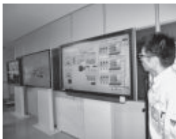
写真-2 中央監視室 監視パネル
