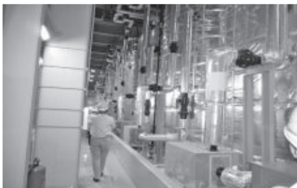
写真-1 蓄電施設内部
