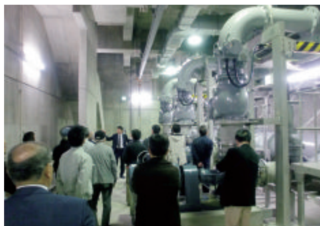
導水ポンプ室内
