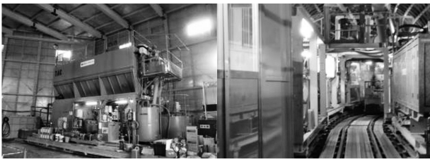
写真 裏込め注入プラント(左)トンネル坑内(右)
