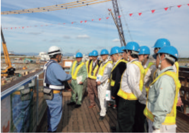
現場にて工事概要の説明を受ける参加者 現場の安全管理等も徹底されています
