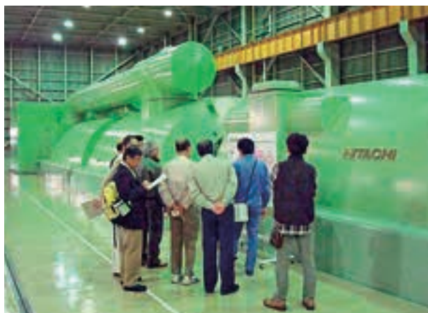
火力発電所内の発電機も見学
