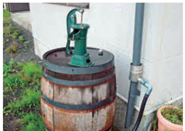
雨水利用の貯水タンクとポンプ
