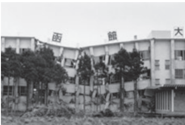
写真-2 倒壊した函館大学
