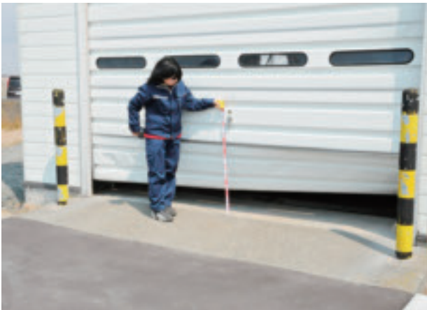
鶴川漁業協同組合厚真支所の津波被害
