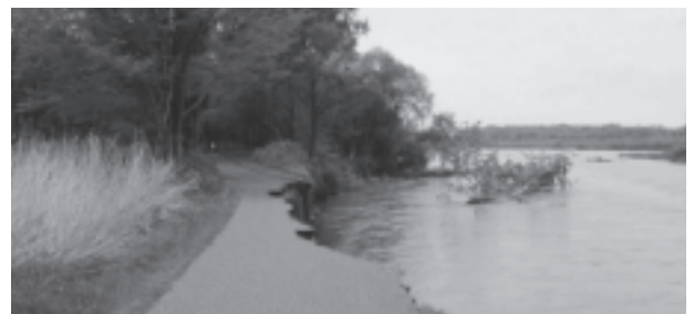
土砂が流出した園路
