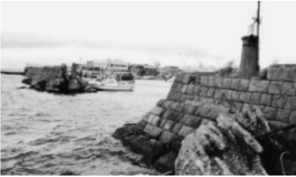
函館漁港の船入間 南西沖地震により傷みが見られる。
