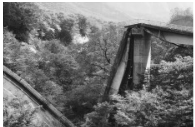
祭時大橋落橋状況
