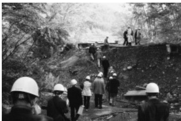
道路被災状況（隆起）
