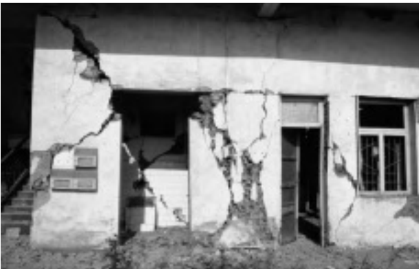
写真-4.5 住宅の被害
