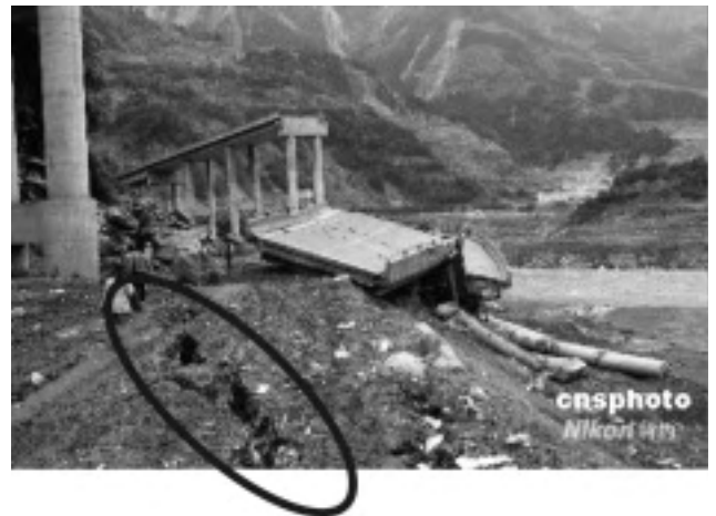
○箇所は、地盤の亀裂箇所 橋梁の斜交に矢印線断層あり、崩壊の要因？
