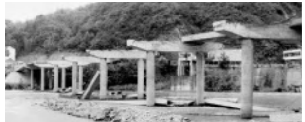
写真-4.15 南提大橋の落橋（西南交通大学提供）
