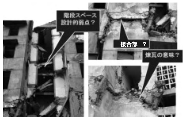
写真-4.10 都江壱市のビル：崩壊細目
