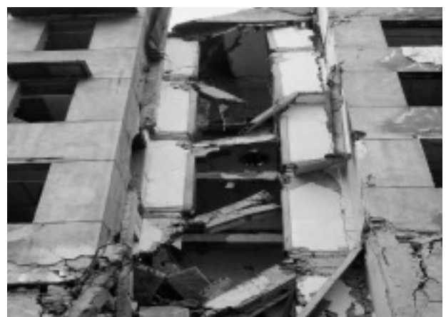
写真-4.9 都江壱市のビル：階段部の崩壊
