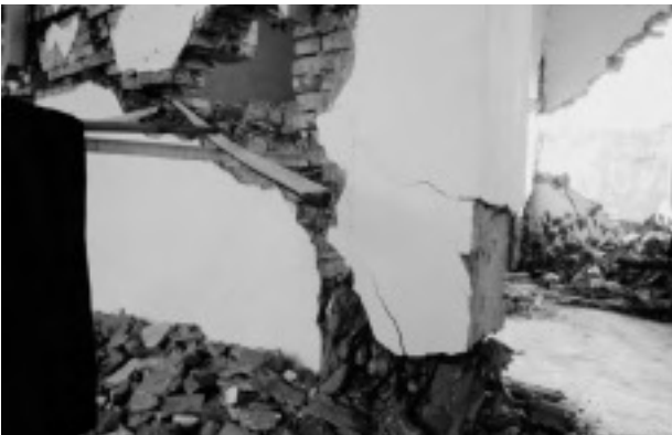
写真-4.4 商店の仕切り壁の崩壊
