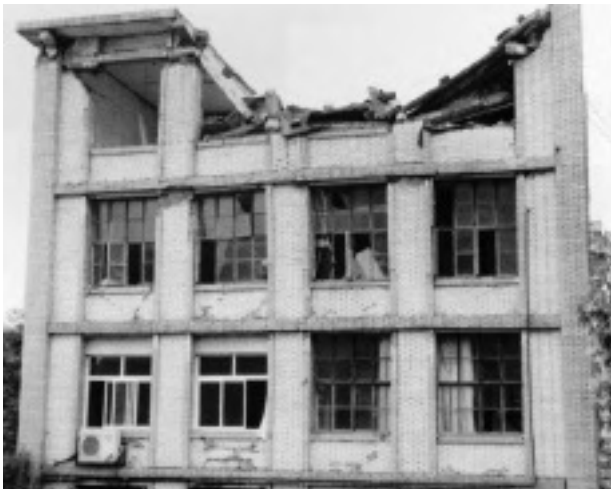
写真-4.12 学校の崩壊（重慶大学提供）
