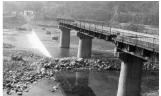
写真-4.14 多径間単純桁橋の落橋
