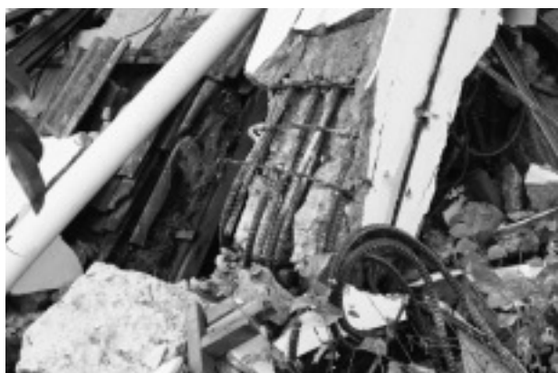
SEWON 郡近郊の建物被災と鉄筋の状態
