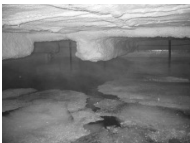
写真-7 氷蓄熱水槽内部
