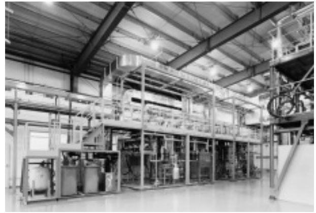
写真-2 水素添加・脱水素・(燃料電池)設備
