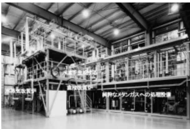
写真-1 バイオガスから水素を生成する設備
