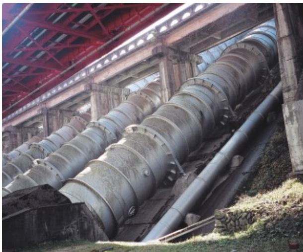
小千谷発電所ペンストック
