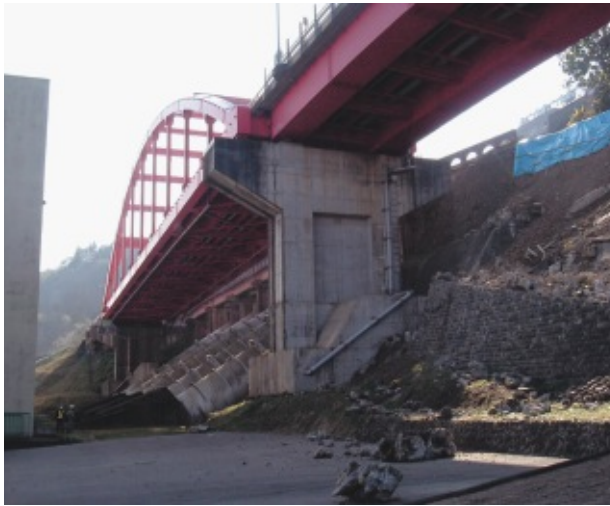
山辺橋および小千谷発電所の被害
