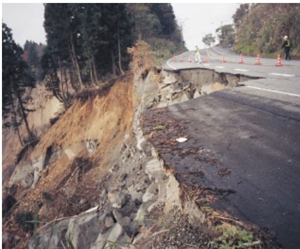
県道川口塩殿線西倉地区道路崩壊
