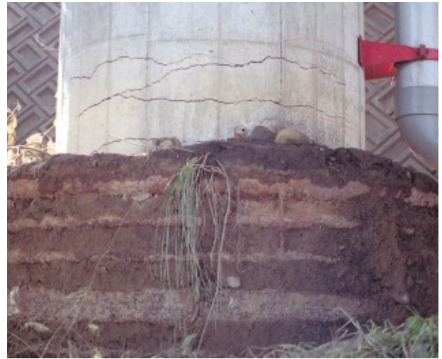
山辺橋 斜面沈下に伴い深礎杭の露出
