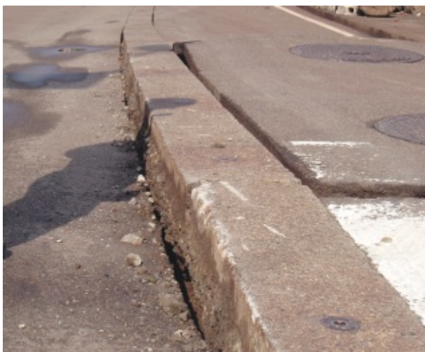
川口町 消雪施設に伴い道路沈下
