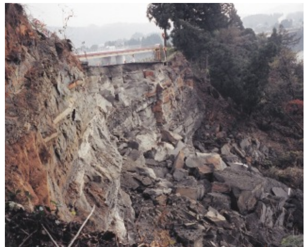
県道川口塩殿線西倉地区道路崩壊
