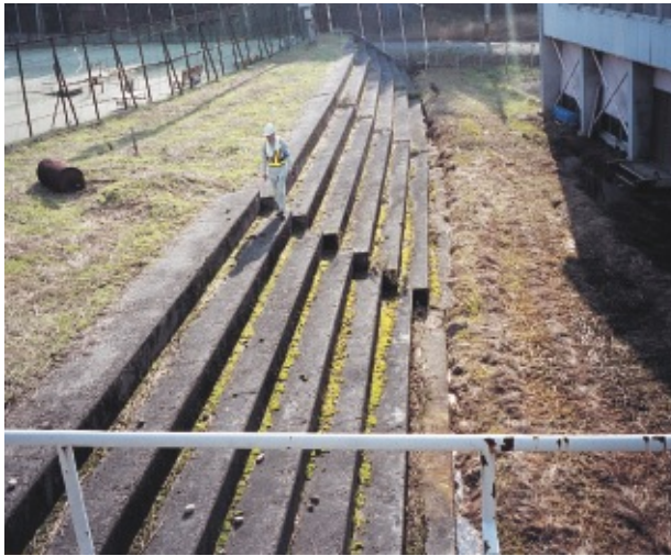
長岡高専 活断層による階段のずれ
