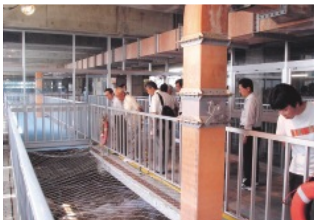
反応タンク（エアレーションタンク） （下水処理センター）
