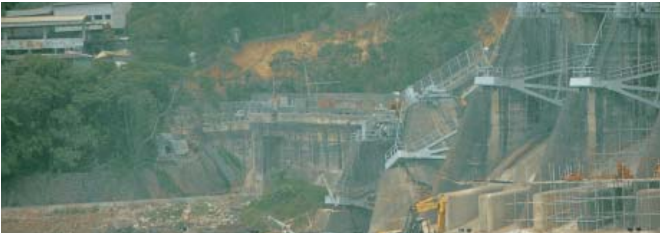
台中県豊原市、石岡ダム破壊状況。 シャローンブー（車籠埔）断層末端部の変位。 右岸河床部が相対的に約8m沈下し、ダムが被害を受けた。 訪問時には盛んに補修工が行われていた。
