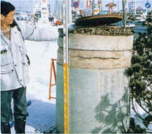
釧路町木場、桂木のマンホールの浮上がり 最大1.50mの浮上がりが生じた。
