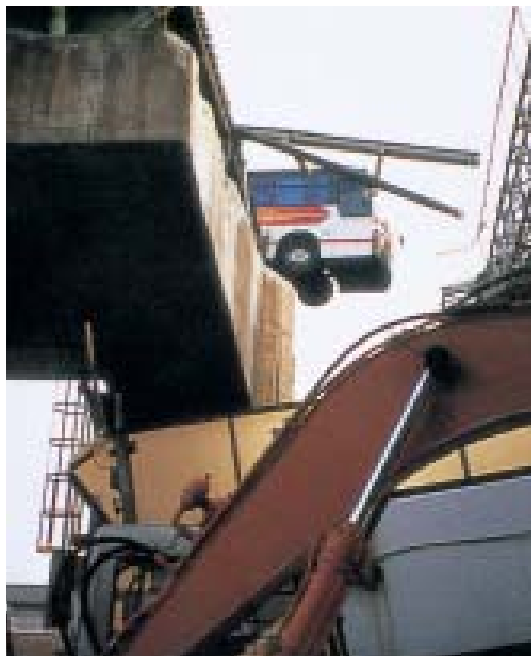
阪神高速3号神戸線 右径間の落橋、そしてバス危機一髪
