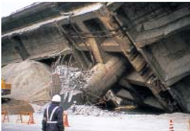
ピルツ橋脚のセン断破壊か？
