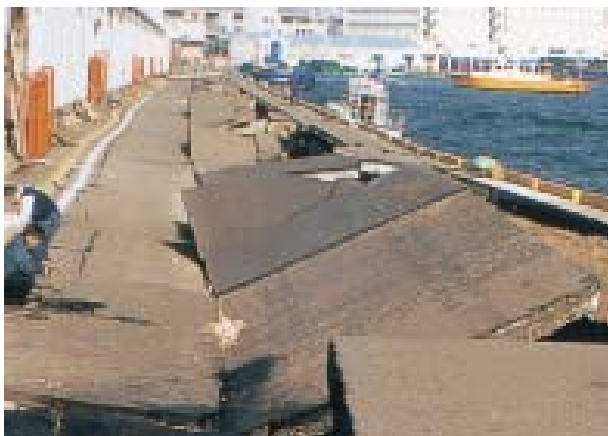
ポートアイランド岸壁の被害
