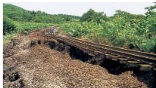
鉄道盛土の崩壊と軌道の変形（JR函館本線長万部町知来―蕨岱間）
