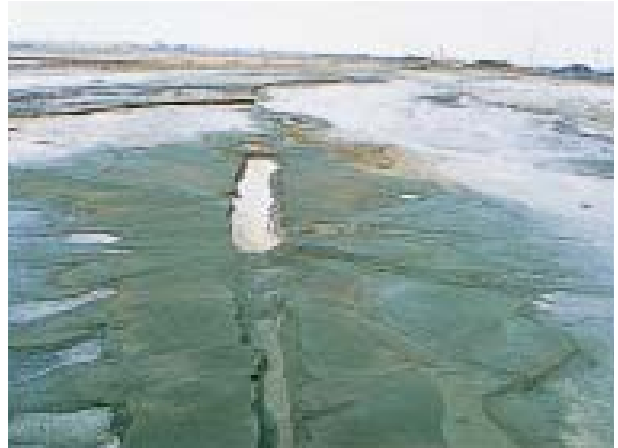
西港第3埠頭、-12m岸壁 岸壁背後地盤の亀裂と噴砂跡 岸壁寄りの区域は液状対策が適用されている。
