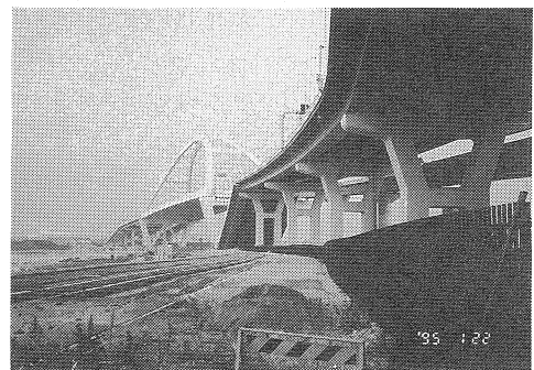
写真-14 西宮港大橋付近 埋め立て地の液状化
