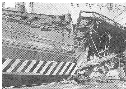
写真-18 阪神電鉄 鉄道高架橋の崩壊
