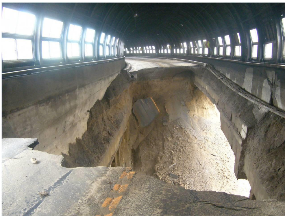
写真-2 国道 274 号 三国の沢覆道被災状況（国土交通省報道資料より）
