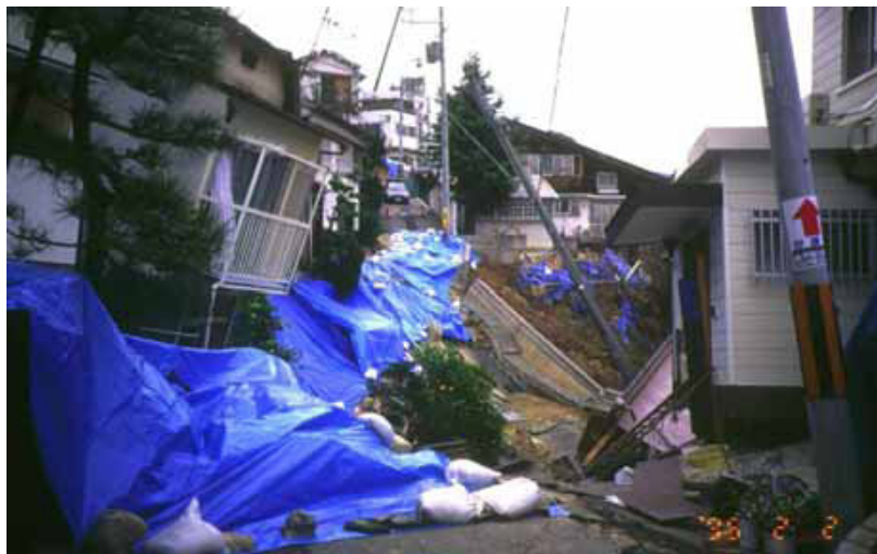
写真-1 阪神淡路大震災における谷埋め盛土の被害 （国土交通省 総合的な宅地防災対策に関する検討会資料）
