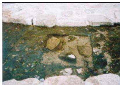
取水ピット（神戸市内住吉川）
