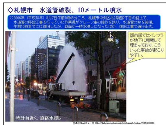
写真-11 札幌市の水道管破裂事故
