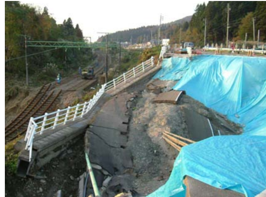
写真-7 新潟県中越地震による国道損壊状況
