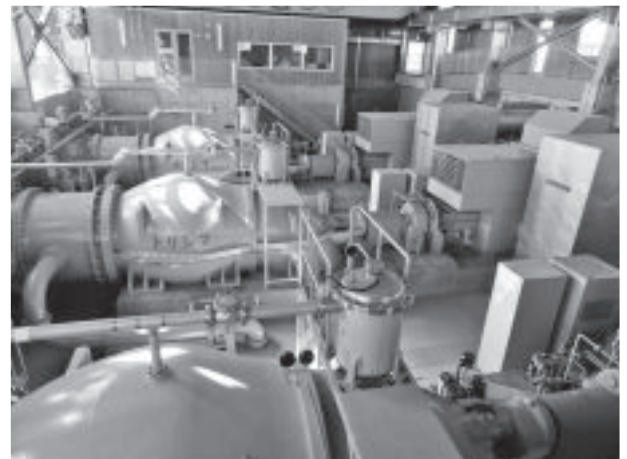
写真-12 南 6 号排水機場内部
