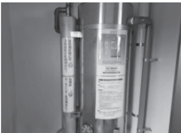
写真-22 雨水貯留装置
