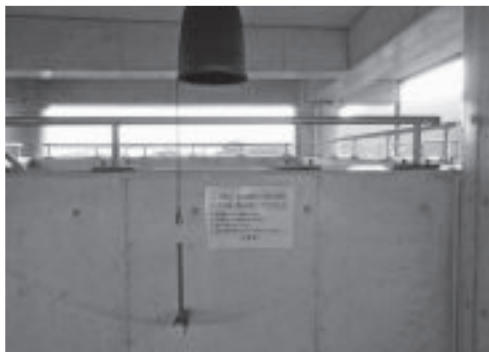
写真-17 タワー3Fに設置された半鐘
