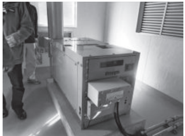
写真-16 非常用電源
