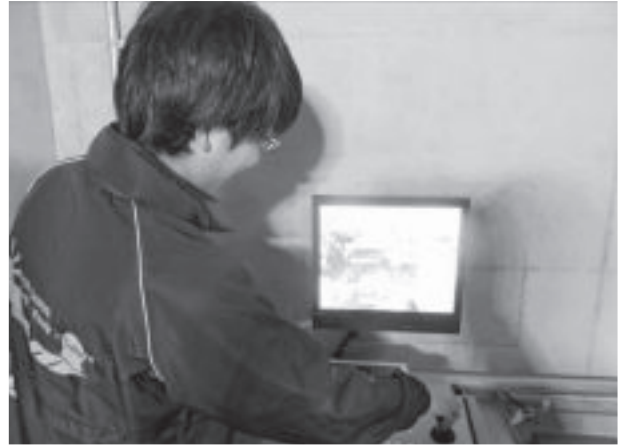
写真-14 監視カメラの映像モニター
