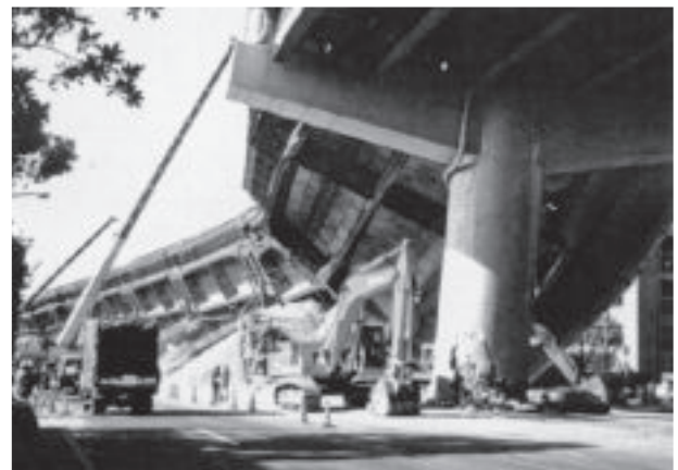
図-10 阪神高速道路3号神戸線の倒壊
