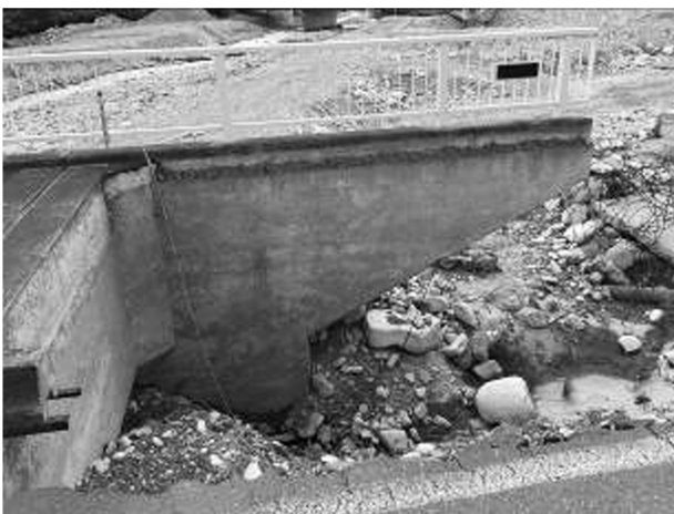
写真-3 橋台背面の洗掘状況(ペケレベツ川)
