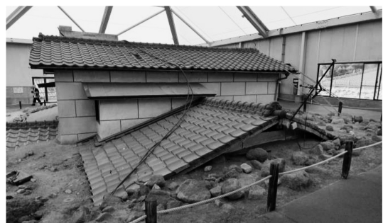
写真-4 土砂に埋まった家屋の様子
