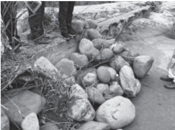
写真-2 被災を受けた河川構造物
