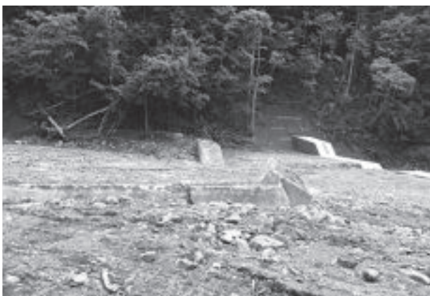
写真-6 丸駒橋上流の損壊した治山施設
