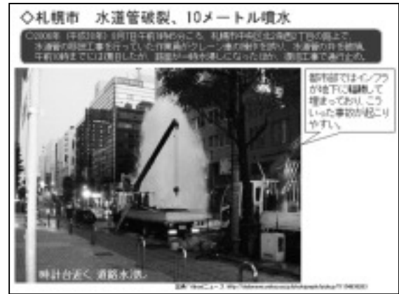
写真-1 札幌市の水道管破裂事故
