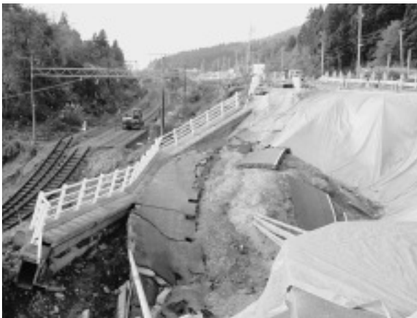
写真5 新潟県中越地震による国道損壊状況
