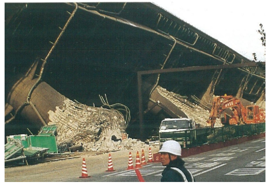
写真 1. 神戸市ピルツ橋の崩落
