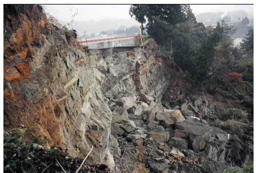
写真 2. 新潟県西倉道路の岩盤崩壊
