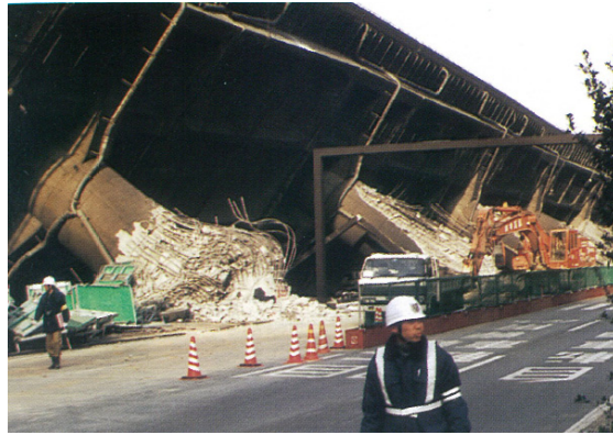
阪神高速 3 号 ピルツ橋台の倒壊
