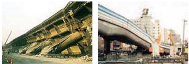
阪神淡路大震災による橋の被害
