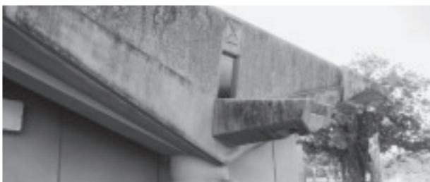
写真-5 ビジターセンター屋根の火山灰排出施設
