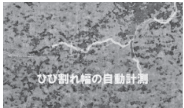
写真-2 AIによるひび割れの自動検出
