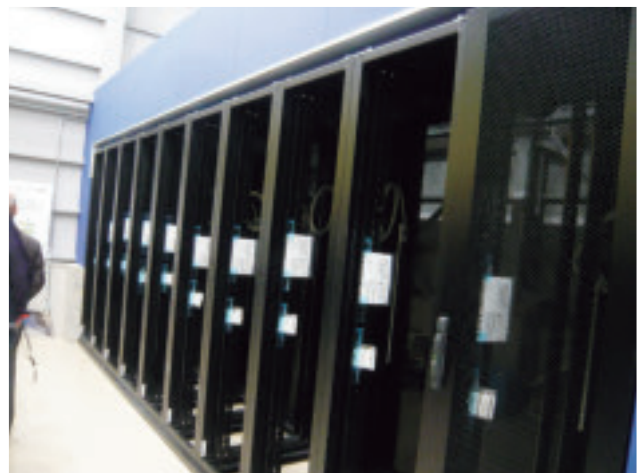
ホワイトデータセンターのサーバー室の(部屋の両側にサーバー保管用の棚が並べられている)
