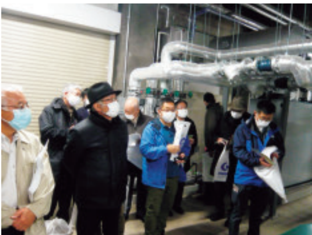
木質バイオマスボイラーの配管の前で 説明を受ける参加者②
