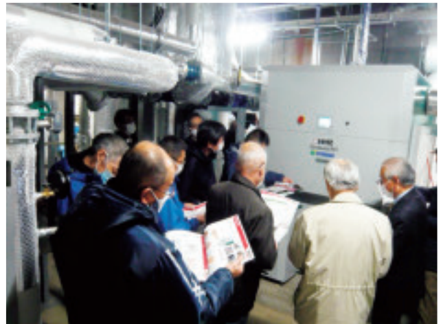
木質バイオマスボイラーの配管の前で 説明を受ける参加者①
