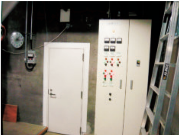
三笠市役所に設置されている木質 バイオマスボイラー
