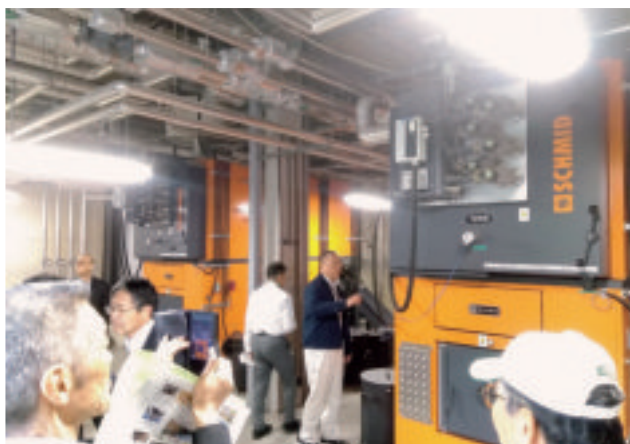
一の橋バイオビレッジのチップボイラ
